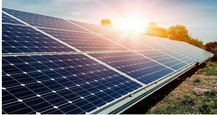
Système à énergie renouvelable
