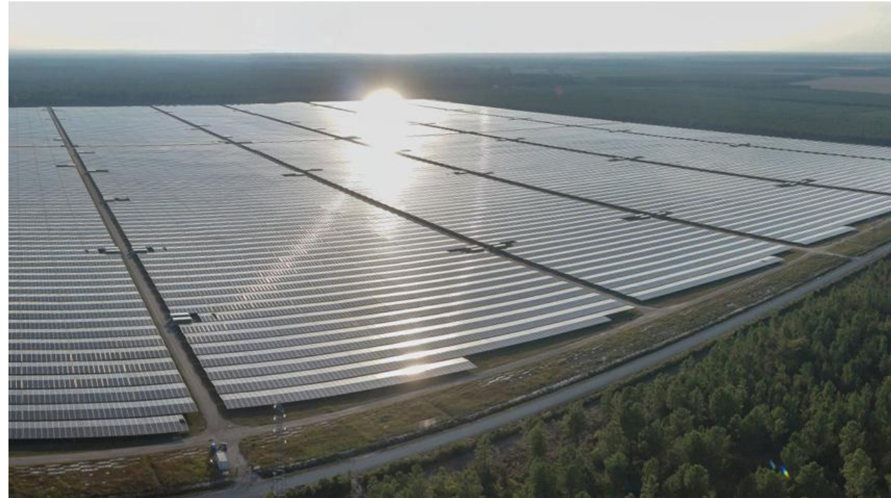
Centrale solaire photovoltaïque de Cestas dans le Gironde
