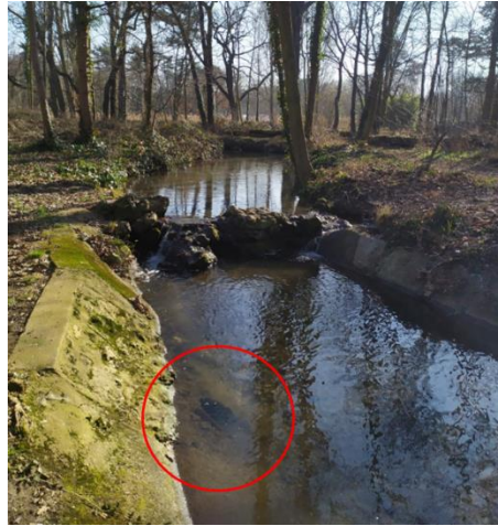
Figure 2.3 : Photographies de la sortie des eaux de l'ouvrage traitées vers la mare Saint-James. Le cercle rouge localise le conduit de sortie de l'eau (Crédit : J. Roux 2021).
